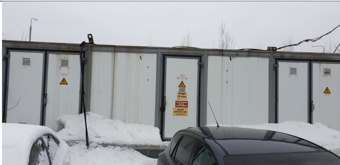
Установленное оборудование РУ 10 кВ
