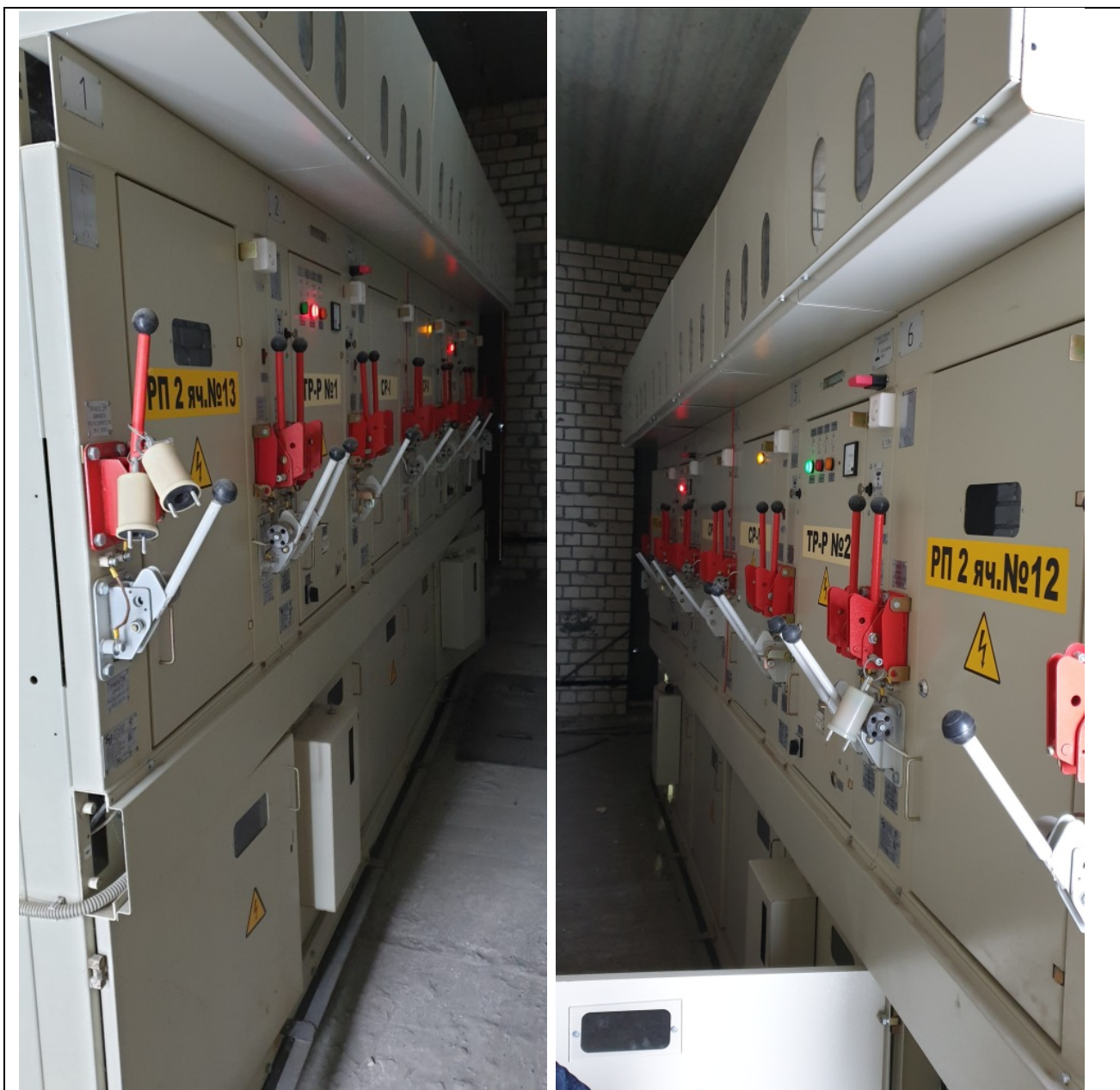
В РУ 10 кВ установлены камеры типа КСО серии 298 с ВВ-10 Установленное оборудование РУ 0,4 кВ
