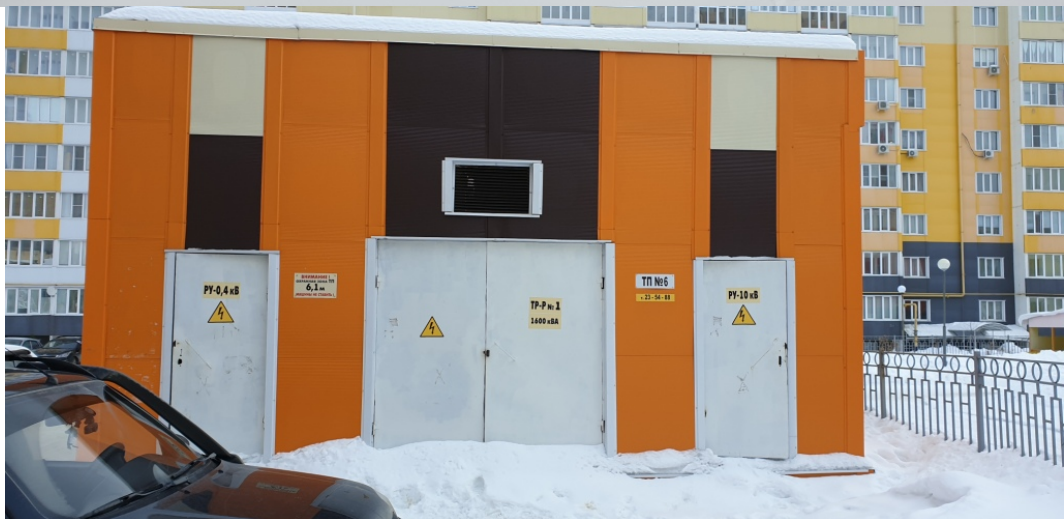
Установленное оборудование РУ 10 кВ
